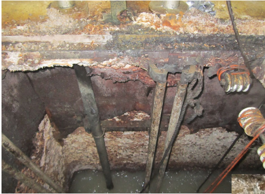
大阪市内某ホテル厨房排水処理施設
